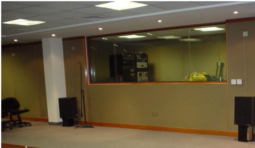
Sala de Telecomunicaciones. Universidad San Martín de Porres
